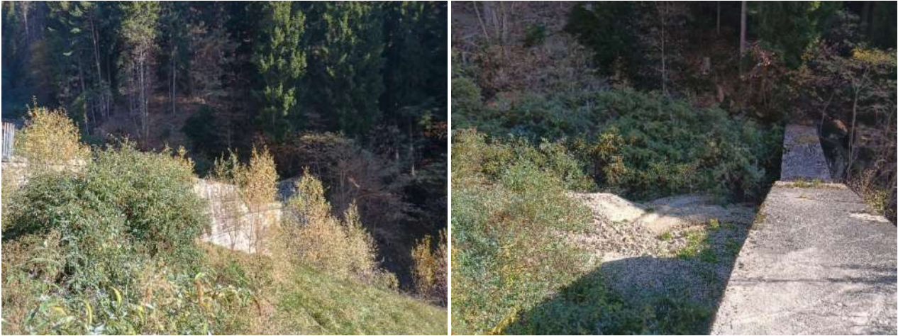
Fig. 1.27 -1.28 - Grande opera in cls armato realizzata dopo l'alluvione del 1966 a quota 886 m s.l.m
